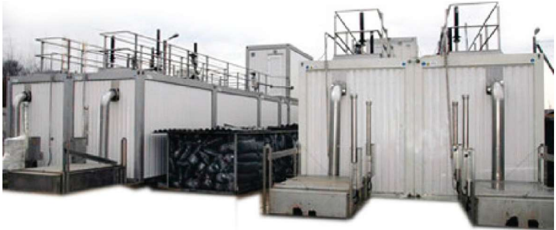
Рисунок 4 - Компактные очистные сооружения глубокой биологической очистки сточных вод блочно-модульного типа «БИОКОМС»
